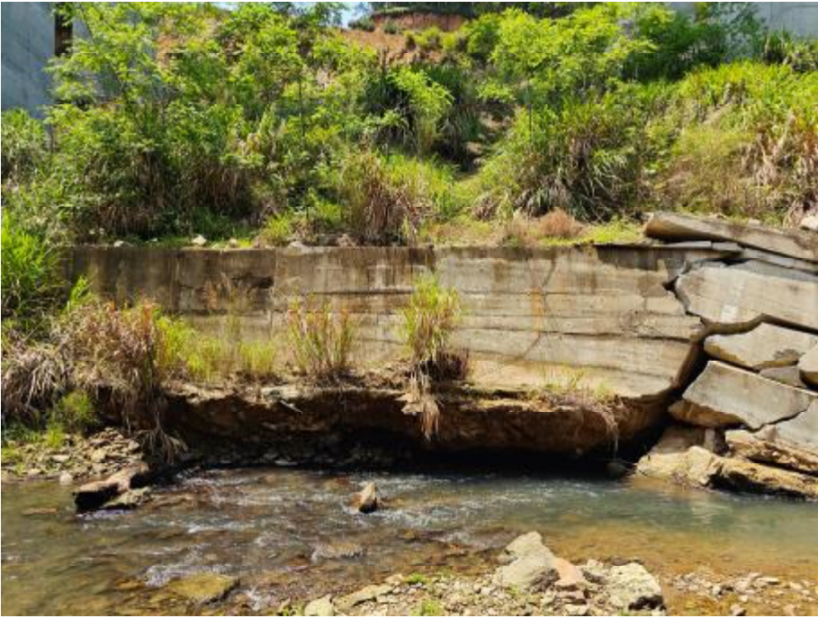
第二处挡墙基础冲刷
