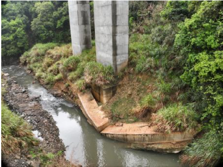
第一处挡墙塌方现状
