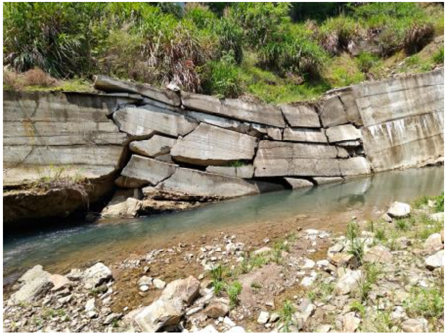
第二处挡墙塌方现状
